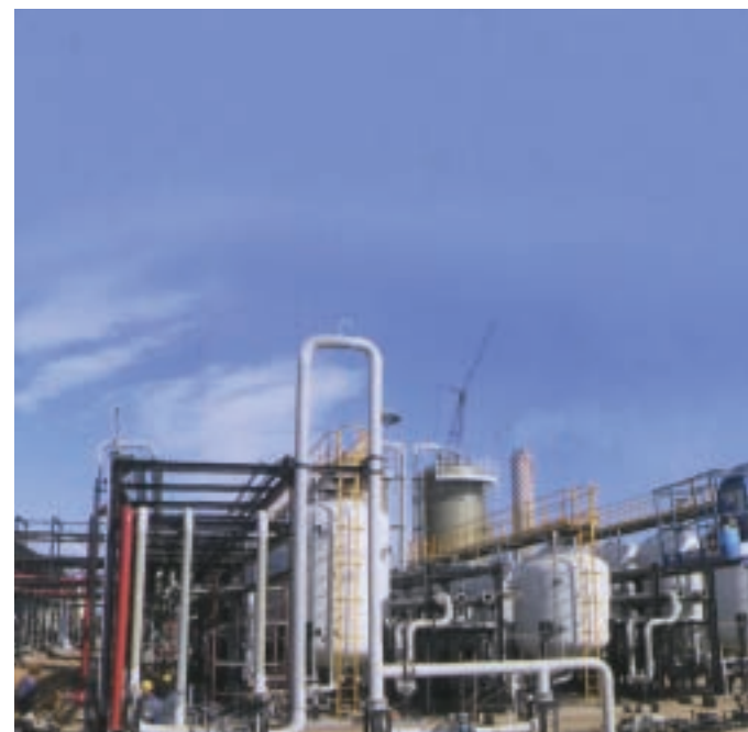
Foto archivio impianto di Gela
